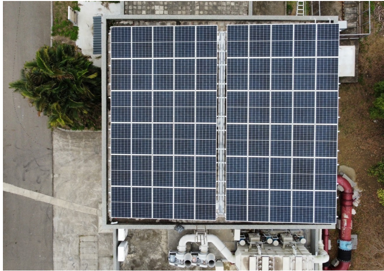
Kuo Yang Solar Panels
