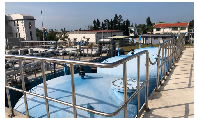
▲大金門 4000CMD 海水淡化廠
