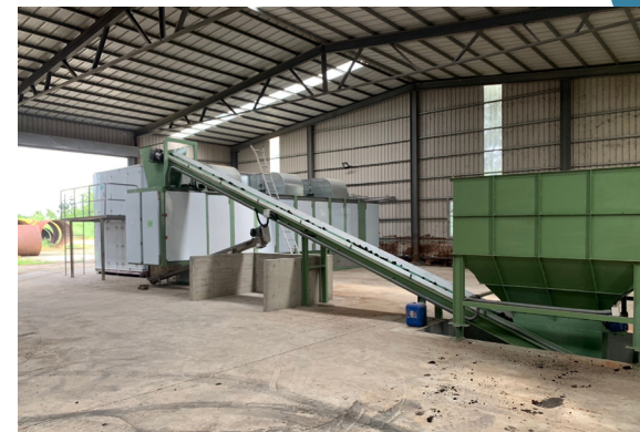
▲污泥減量設備
