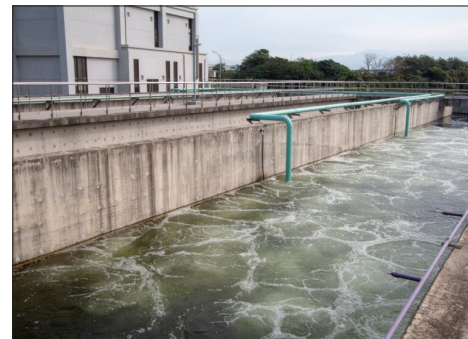
▼ 後龍水資源回收中心(氧化渠)
