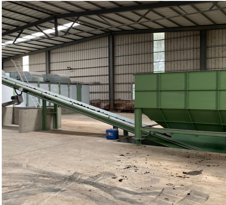
▲污泥減量設備
