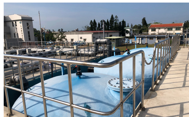
▲ 大金門 4000CMD 海水淡化廠
