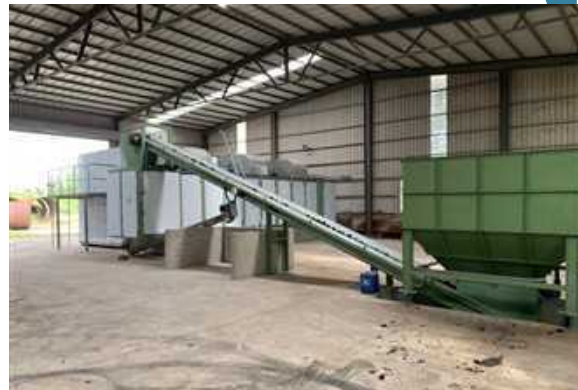
▲污泥減量設備
