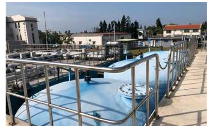
▲大金門 4000CMD 海水淡化廠
