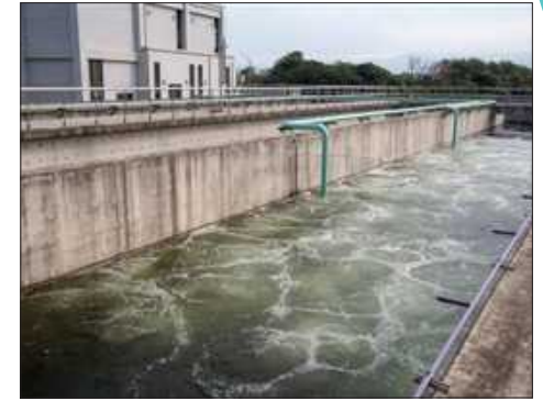
▼ 後龍水資源回收中心(氧化渠)
