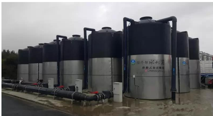
產水送水設施
