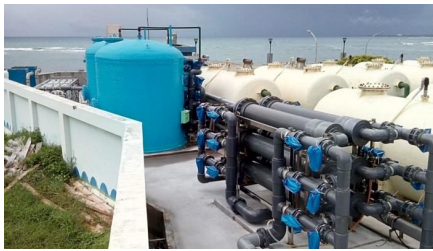
2000CMD 機組實廠照片
